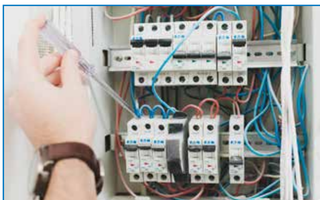
Bảo trì, sửa chữa toàn bộ hệ thống (cơ, điện, phần mềm)
