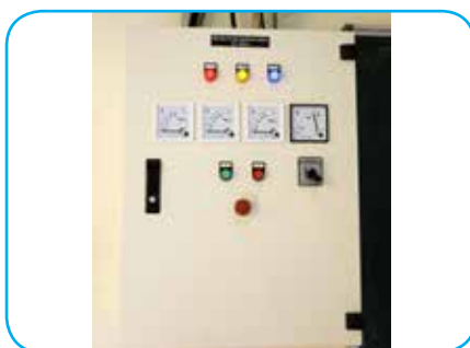
Tủ cung cấp nguồn
