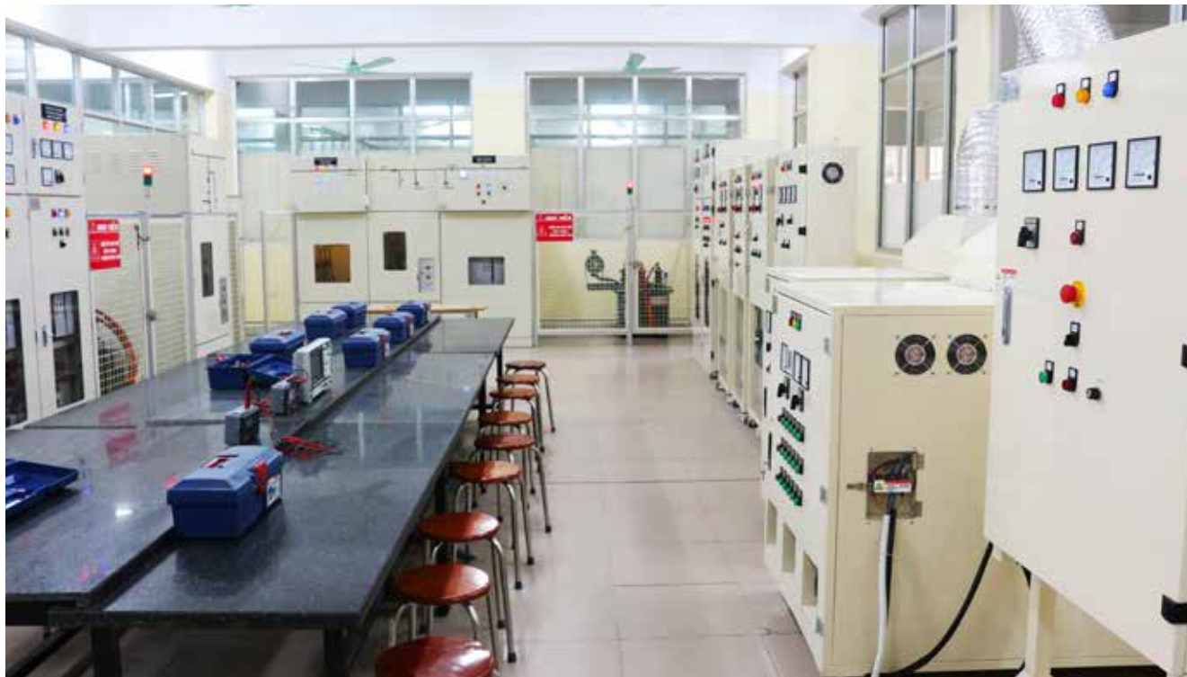
Phòng cung cấp điện
