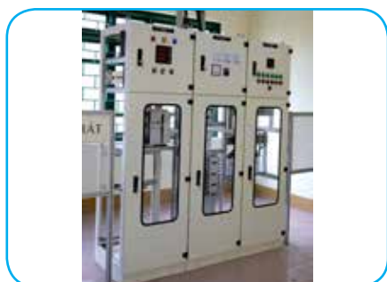
Hệ thống tủ phân phối hạ áp
