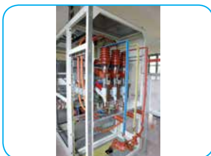
Tủ nhận điện đầu vào
